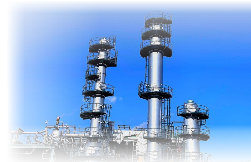
千葉工場CO 2 回収装置
