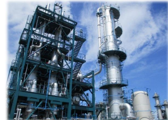
千葉工場 生産設備(2024年増強)
