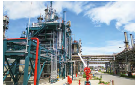
完成した千葉工場のイソノン酸製造設備
